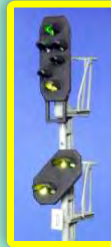
5851 Hauptsperrsignal mit Vorsignal
